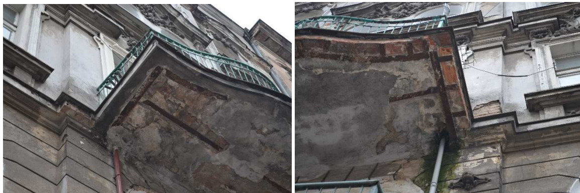
odsłonięte tynki spodów płyt balkonowych II p
