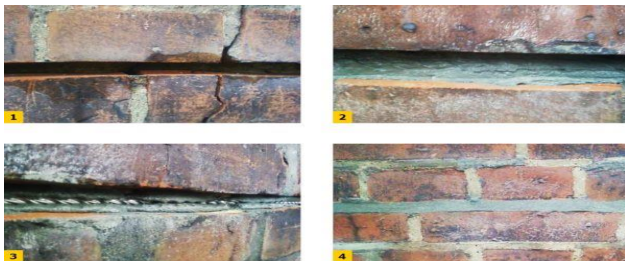
Rys. 1. Technologia naprawy (wzmocnienia) muru poprzez zszycie rys i pęknięć za pomocą zbrojenia stalowego (rysunek poglądowy) [6-15].
